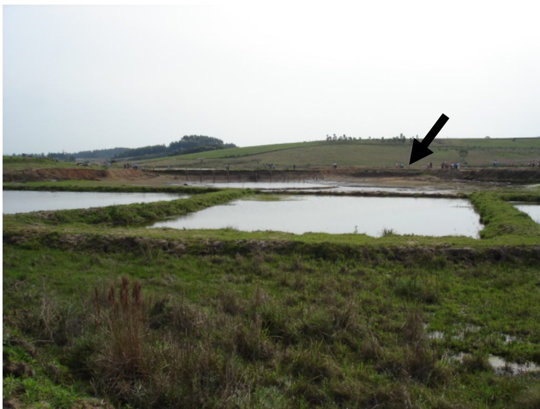
Figura II-3. Tanque de piscicultura vazio devido a rompimento de talude.
